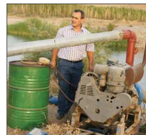
Eine Wasserpumpe für das Dorf Qarawella
